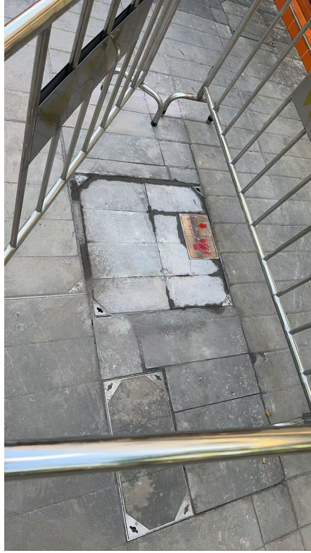
图 2：改造后的隐藏式消火栓外观
