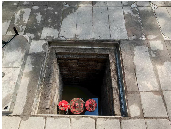
图 3：改造后的隐藏式消火栓内部样式
